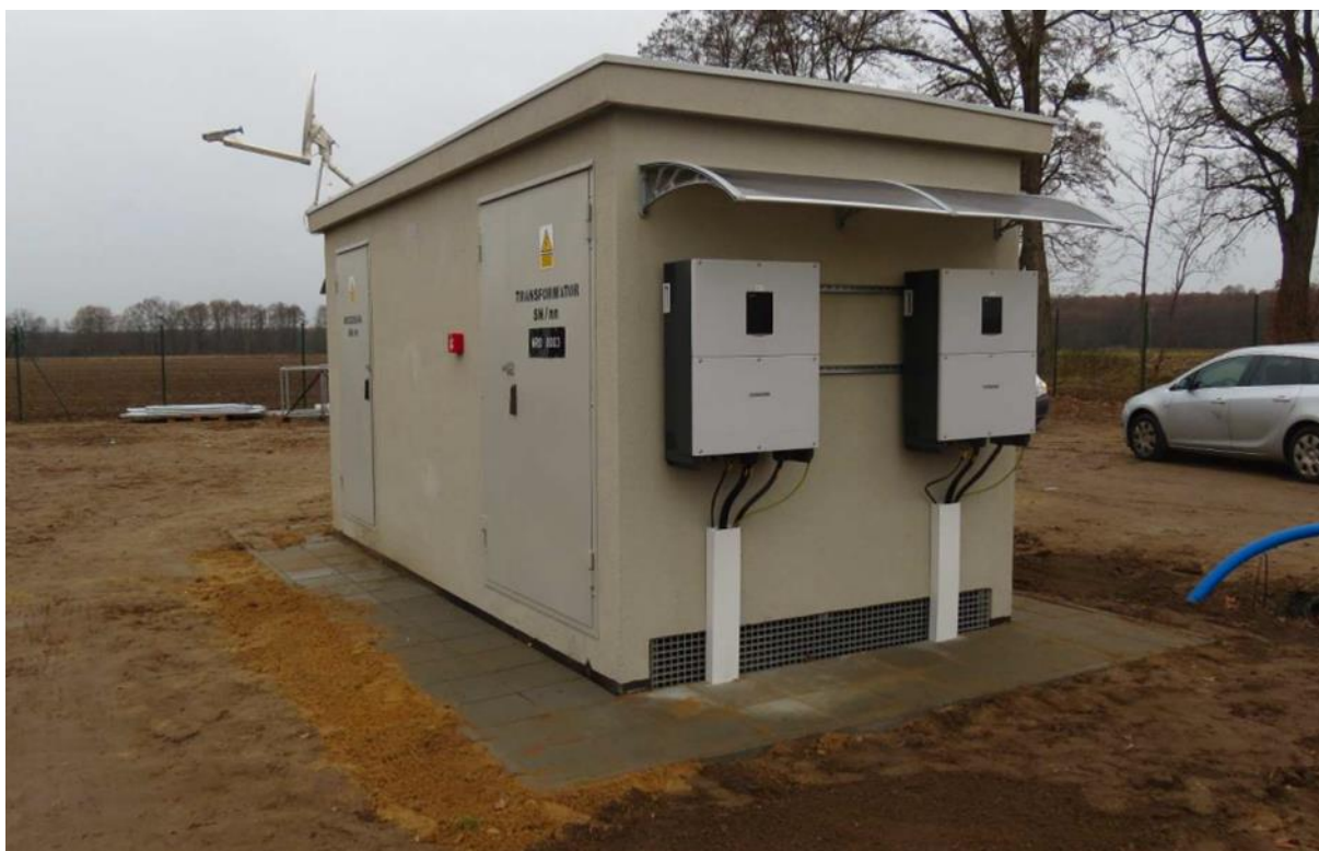
Rysunek 8. Przykładowa stacja transformatorowa z zainstalowanymi inwerterami
